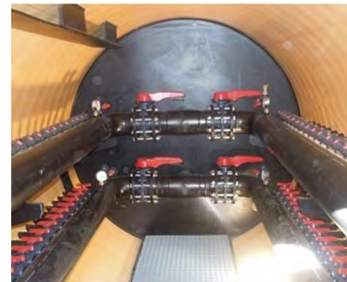
Erdwärmesonden Sammelement innen Ansicht © Stadtwerken Warendorf
