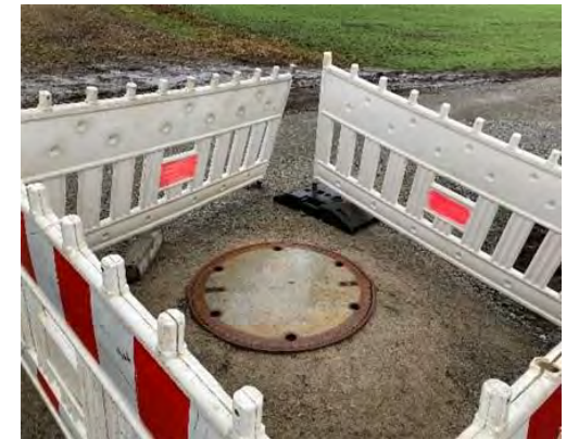
Erdwärmesonden Zugangsschacht für Wartungsarbeiten © Stadtwerken Warendorf
